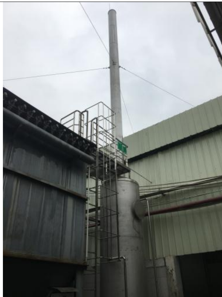
1t/h加热炉烟囱 2#排气筒、布袋除尘+水喷淋
