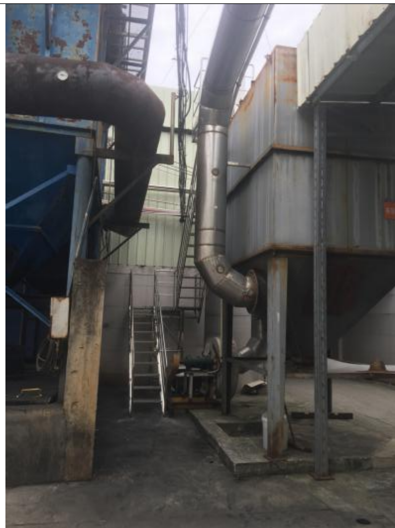
加热炉废气检测平台
