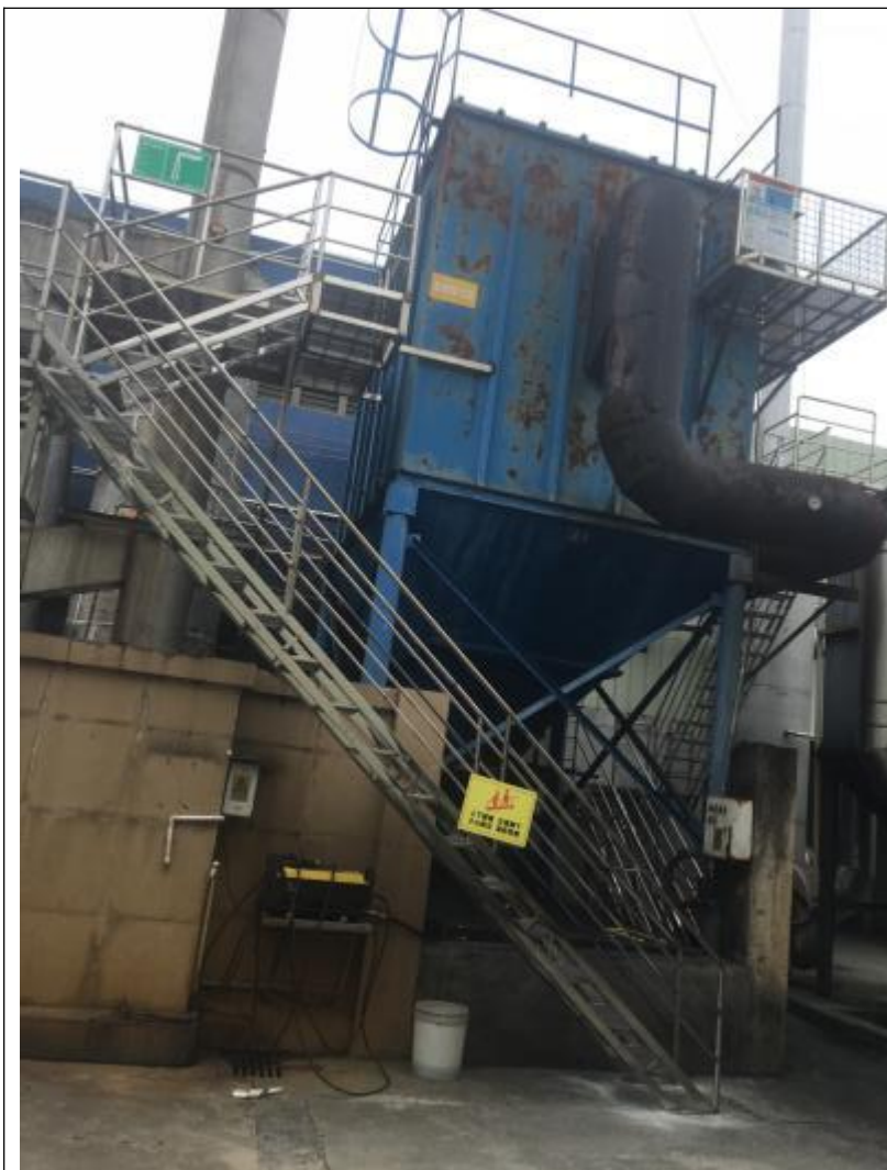
锅炉废气检测平台
