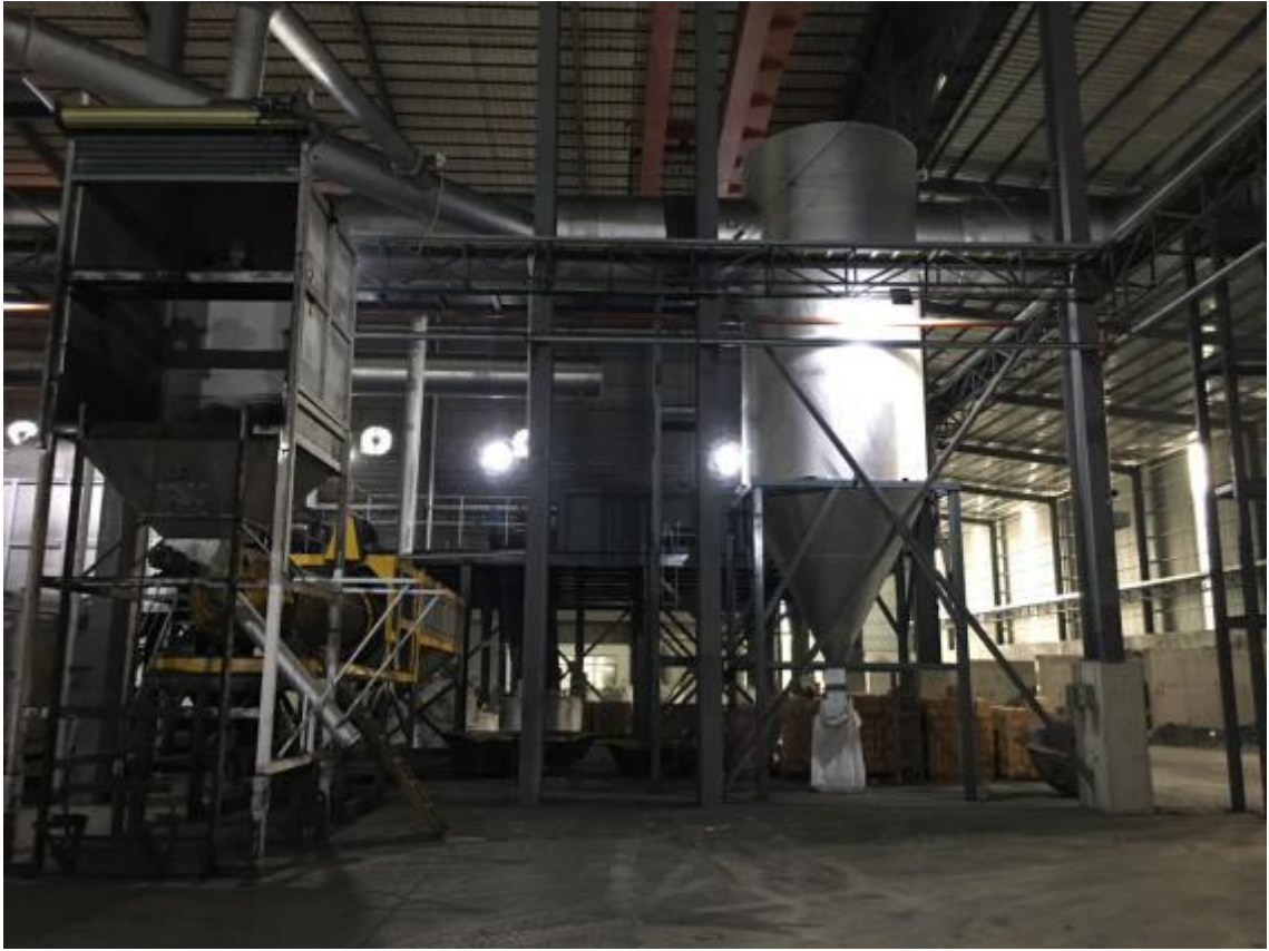
图 4-6 搓灰炉的第一级旋风除尘设施图
