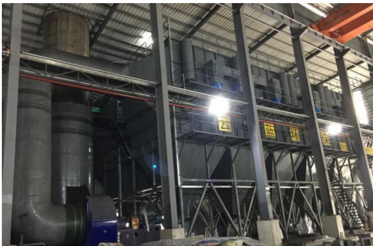
图 4-5 熔炼炉的“两级旋风除尘+静电除尘”设施图
