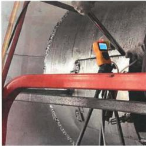
搓灰废气处理前采样口
