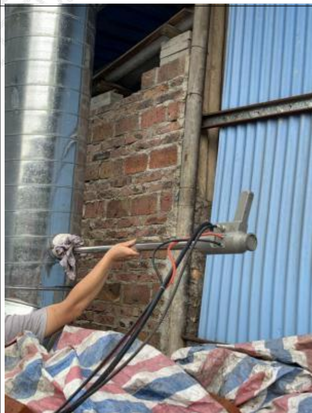
混合搅拌工序废气处理前检测口 ◎Q3
