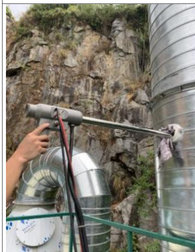
生产车间废气处理后检测口 ◎Q2
