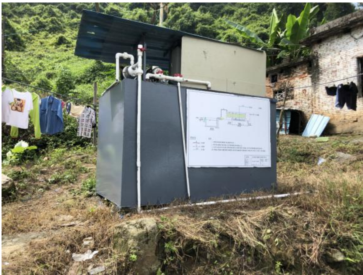
生活污水一体化处理设施
