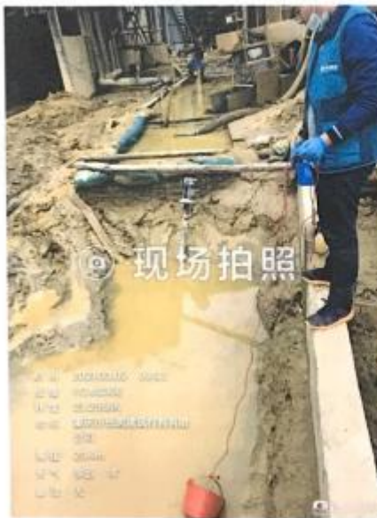
工艺废水排放口
