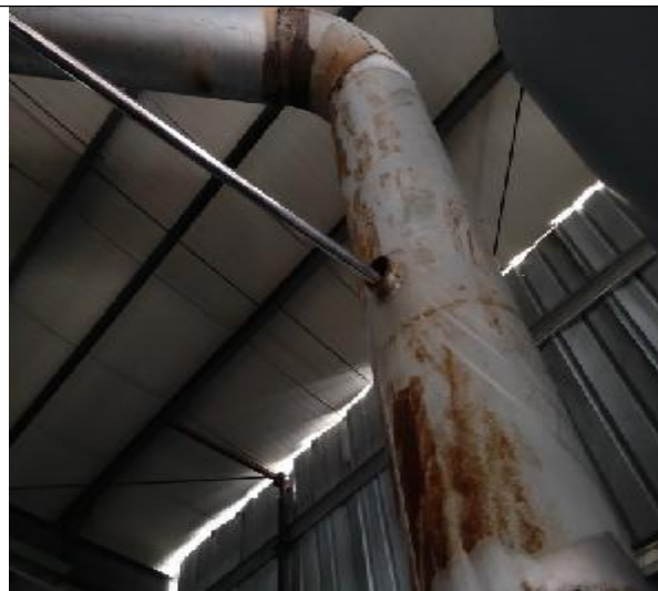
熔铸废气排气筒处理前
