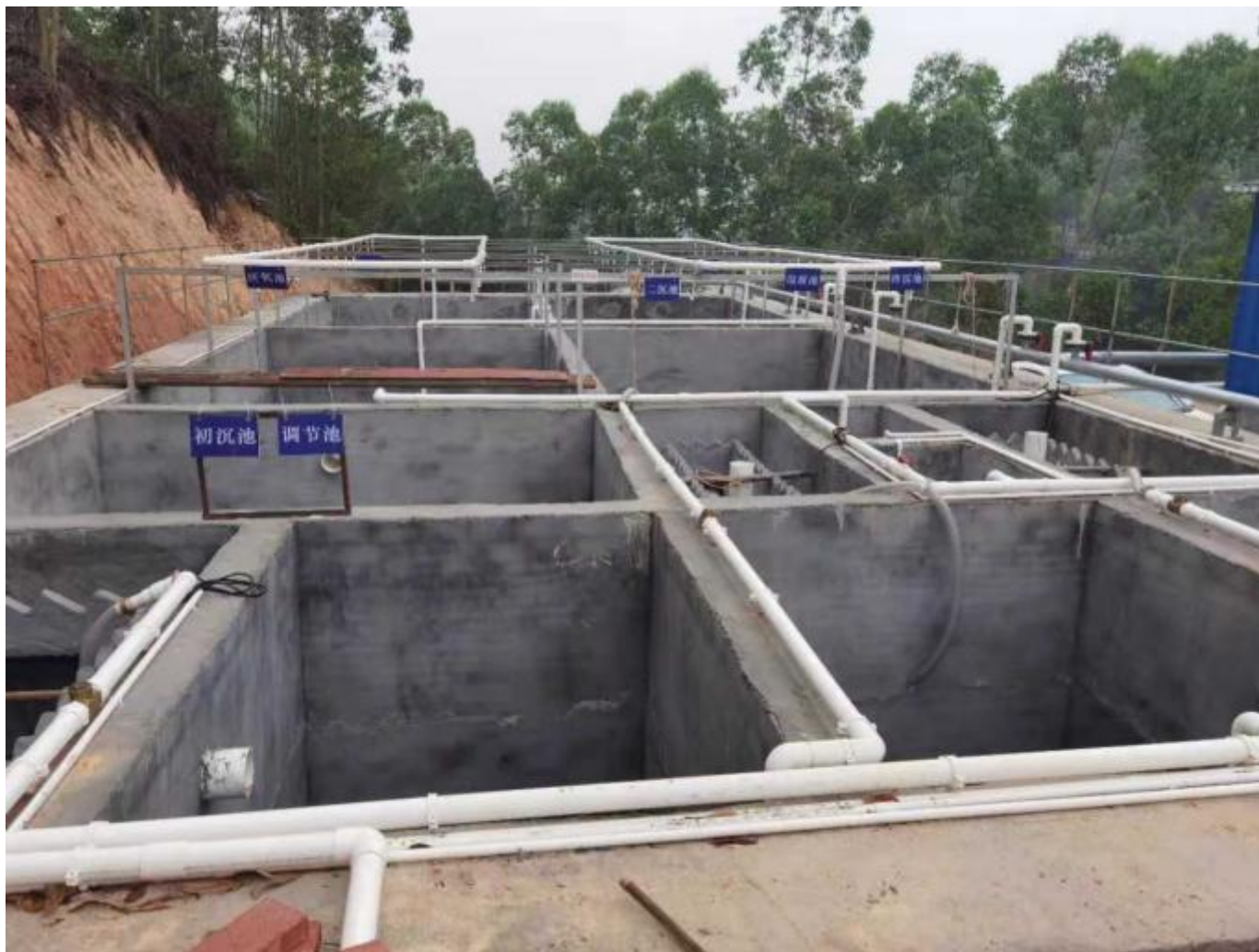
附图 8 厂内污水处理站
