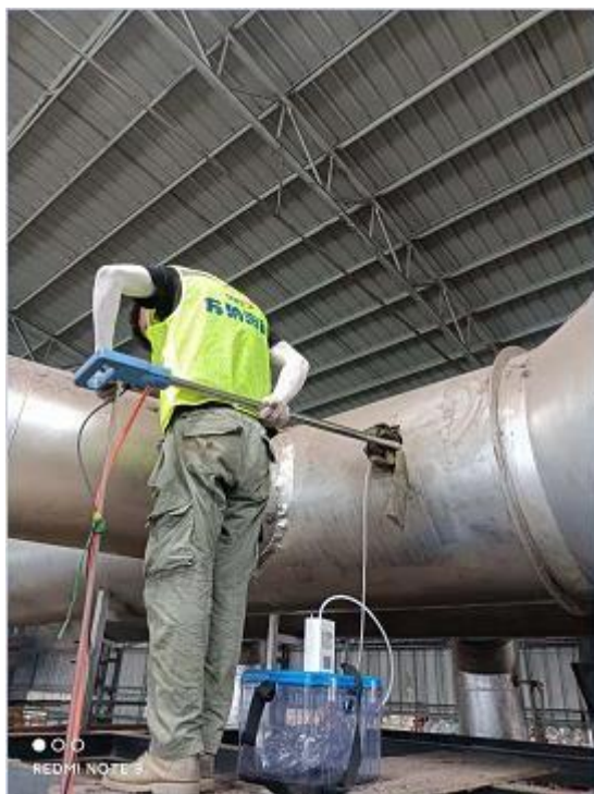
定型机 1 废气处理前
