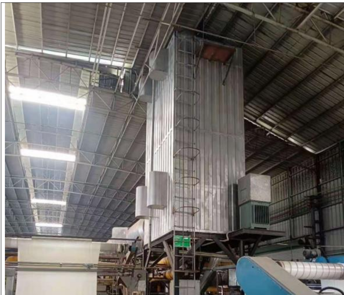
附图 6 本项目的废气治理设施及其排放口标识
