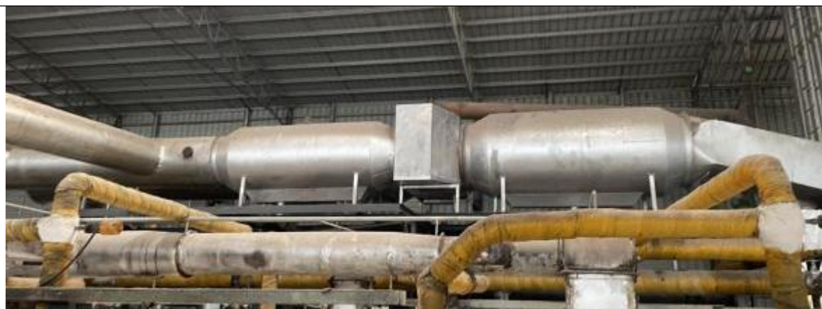
定型车间② “水喷淋+湿式高压静电” 废气治理设施及其排放口标识
