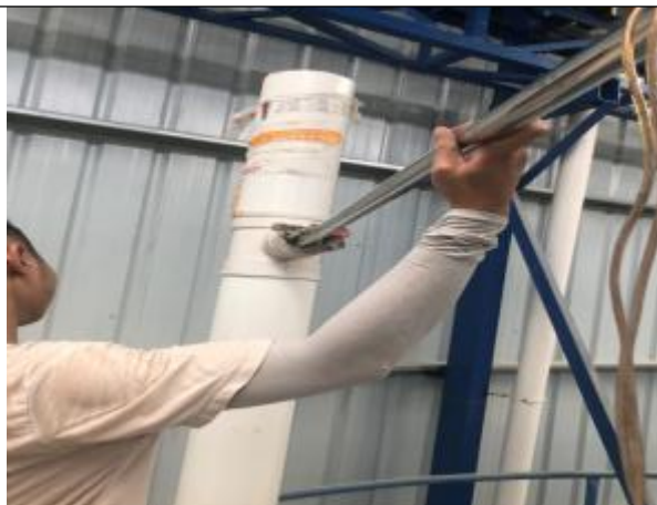
筒仓顶部呼吸孔及底部粉尘排气筒
