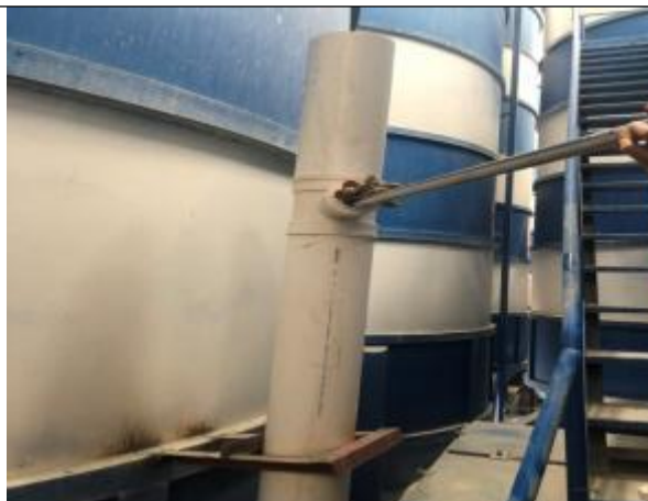
搅拌系统粉尘排气筒
