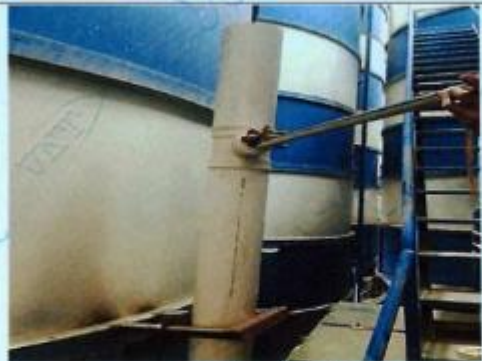
搅拌系统粉尘排气筒
