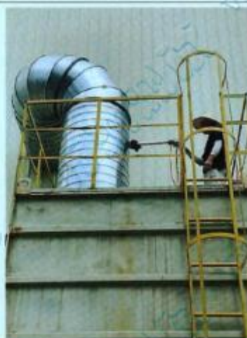
喷砂废气排放口处理前
