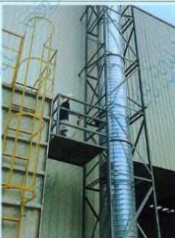
喷砂废气排放口处理后
