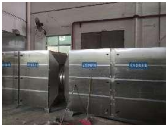
气旋塔+二级活性炭吸附装置
