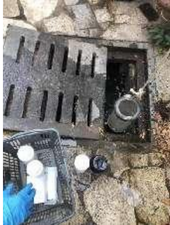
DW002 生活污水排放口
