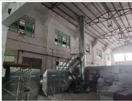
气旋塔+二级活性炭吸附装置
