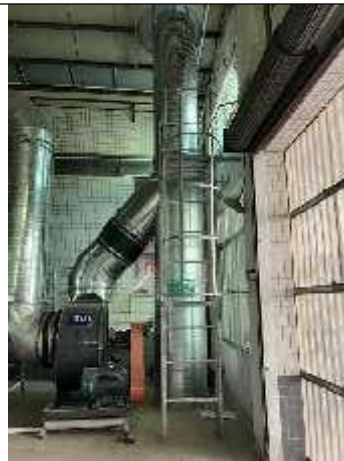
“干式过滤+布袋除尘器” 排气筒
