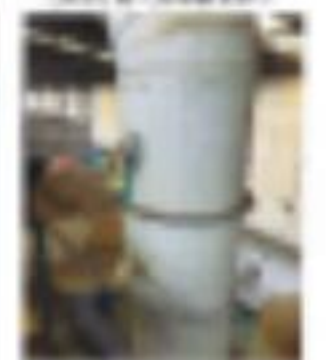
圖 10-10 水質檢測設備安裝圖
